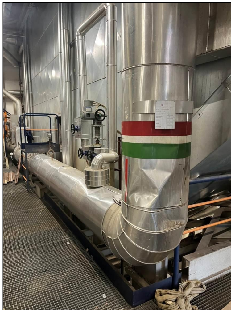
Sl. 1-6: Mjesto ugradnje elektrozagrijača pare u kotlovnici
